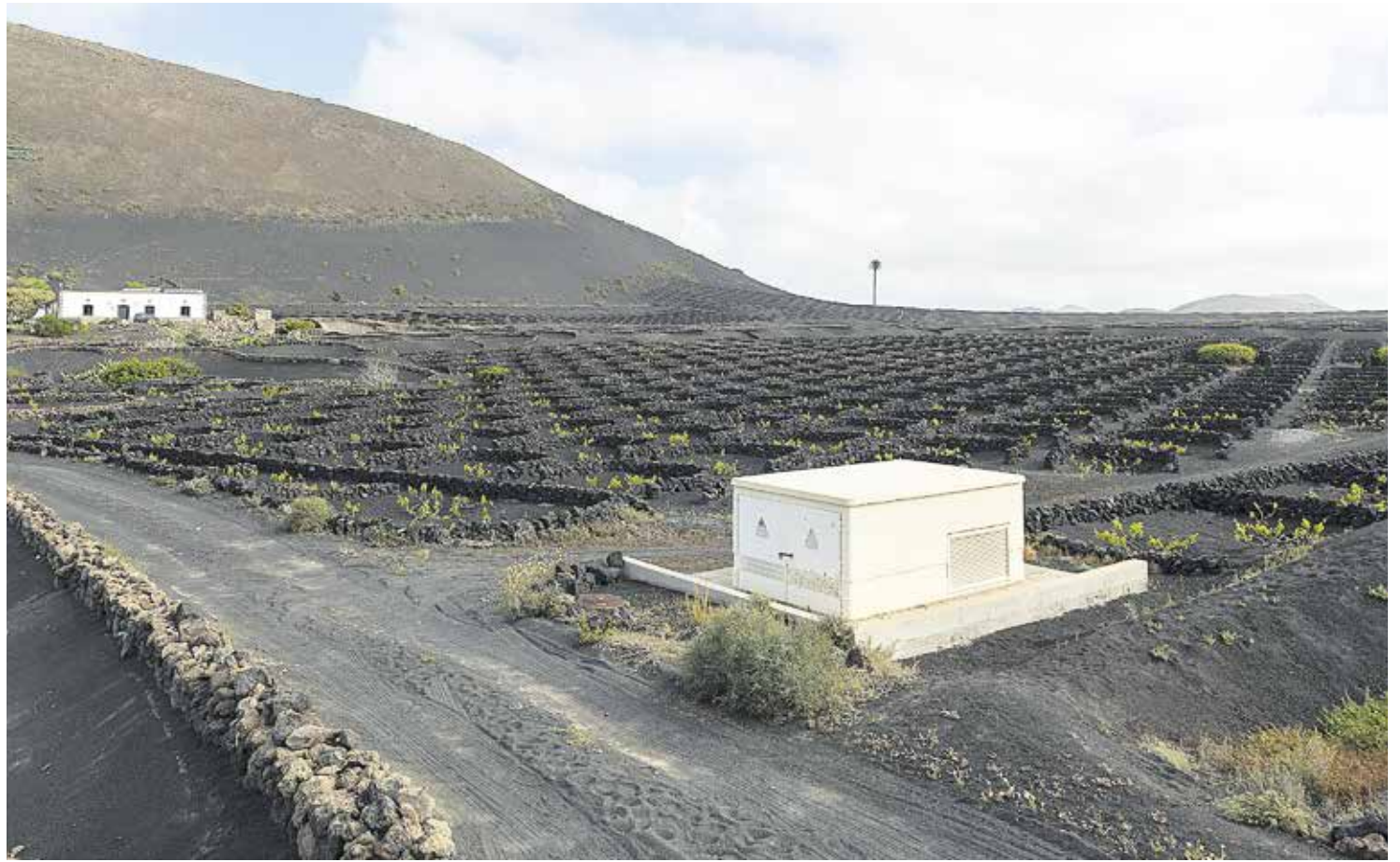
Estación transformadora de La Geria. Foto: Adriel Perdomo.
