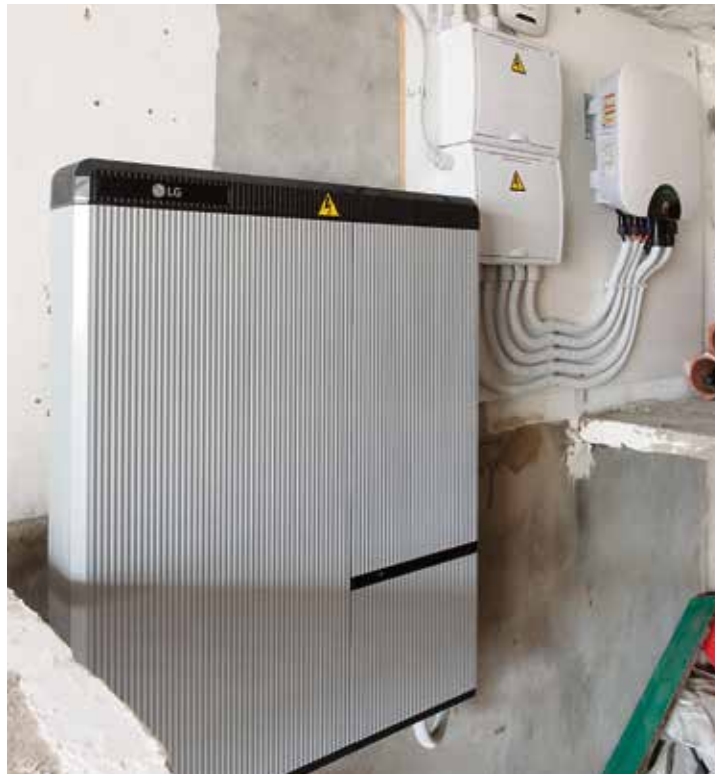
Instalación eléctrica en una vivienda.
