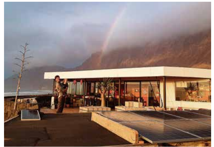
Instalación fotovoltaica en Famara.
